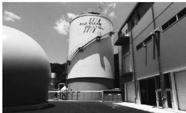
乾式メタン発酵施設（縦型の大型施設としては国内初）
