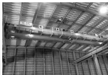
天井クレーン
