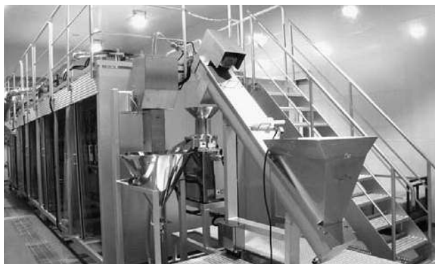
バイオマス再資源化装置（連続式）
