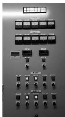
現場 水処理制御盤 外面写真
