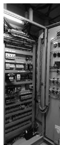
盤内 ミマット設置 状況写真
