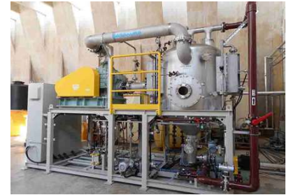
【製塩システム(海水減圧濃縮装置)】
