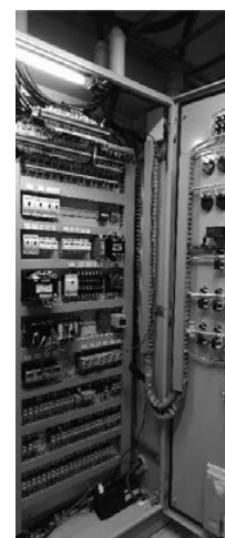
盤内 ミマット設置 状況写真
