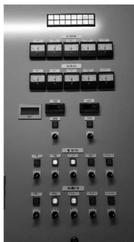
現場 水処理制御盤 外面写真
