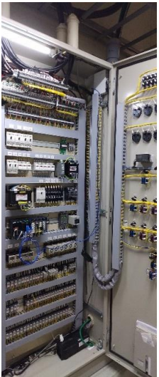
↑ 盤内 ミマツ設置
