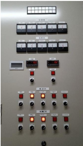
↑ 現場 水処理制御盤 外面写真
