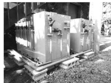
「自然流浄化工法」を用いた 浄化システム
